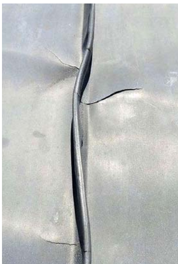
Risse neben Stehfalz, verursacht durch Schublasten (Ausdehnung) und Behinderung der notwendigen Beweglichkeit.
