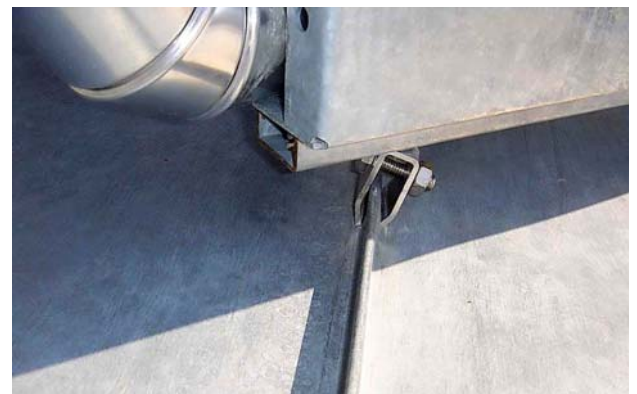
Verformung durch Zwängung: Wegen starrer Profilfixierung über mehrere Stehfalze können seitliche Temperaturexpansionen der Tragschienen zu Schäden führen.
